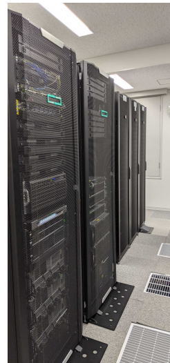
シミュレーションシステム （合計4ラック）
