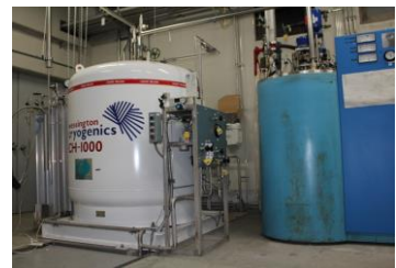
理学部低温センターのヘリウム液化機と1000リットル貯槽。
