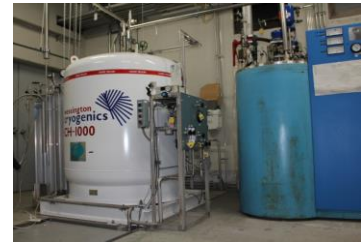
低温センターのヘリウム液化機と1000ℓ貯槽。
